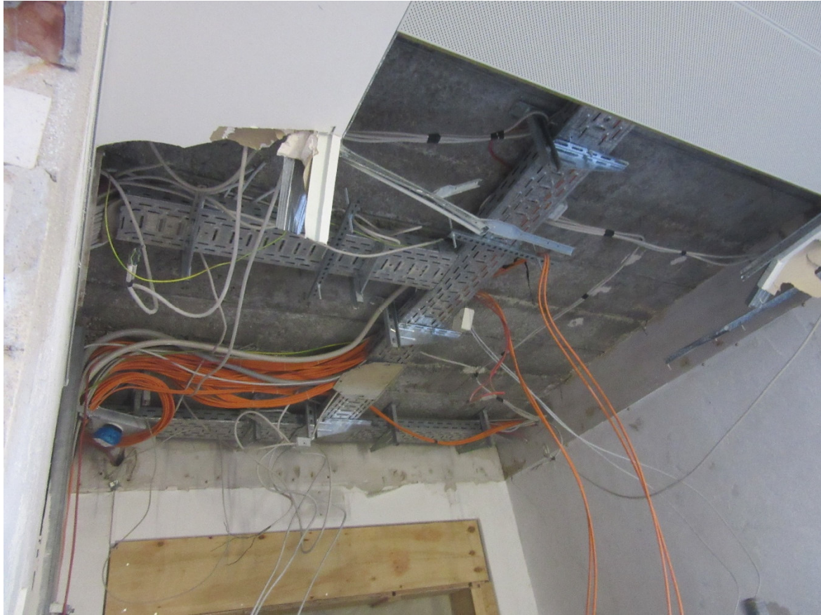
Foto 1 – Kabelpritsche/Kabel in Deckenhohlraum Flur, 1. OG
